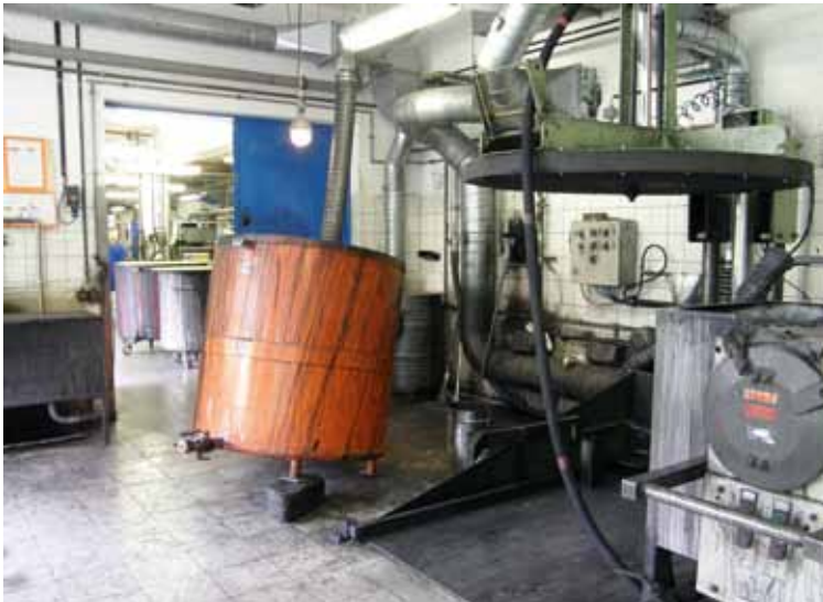
Abbildung 11: Räumlich getrennter Arbeitsbereich für Behälterwaschanlage, Hobbockreinigungsautomat und Handwaschbecken, mit RLT-Anlage und zusätzlichen Objektabsaugungen für manuelle Nacharbeiten bei der Behälterreinigung
